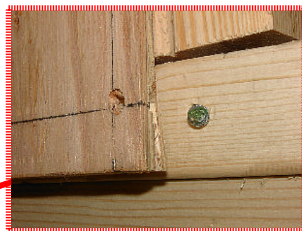
写真1 釘頭の貫通 (パンチング)
