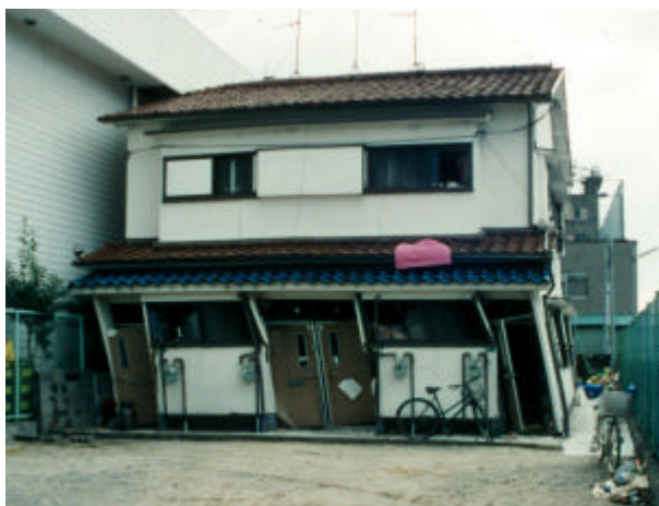
写真3 阪神・淡路大震災後の変形した木造住宅
